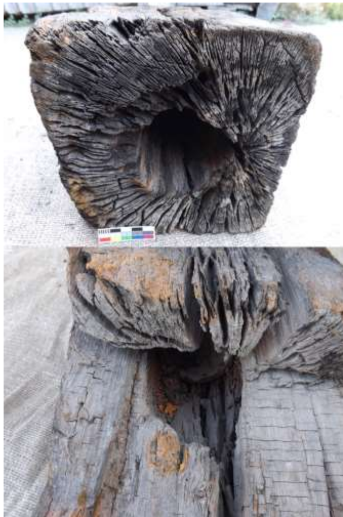
Рис.6. Пошкодження торцевої частини балки
